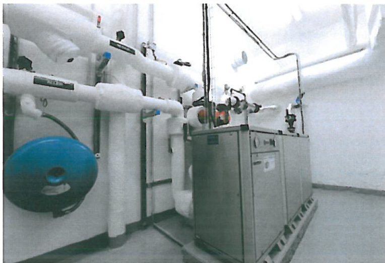
Le système de chauffage du groupe scolaire Wattignies (12 e ) réutilise les eaux usées.
